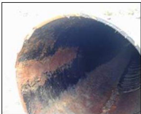
Figura 1. Corrosión interior en oleoducto
