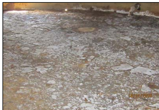
Figura 2. Corrosión interior en tanques
